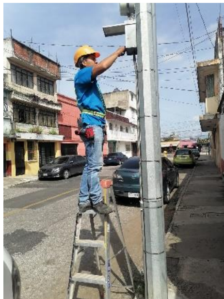
Fotografía 16 Instalación de Puntos de Monitoreo
